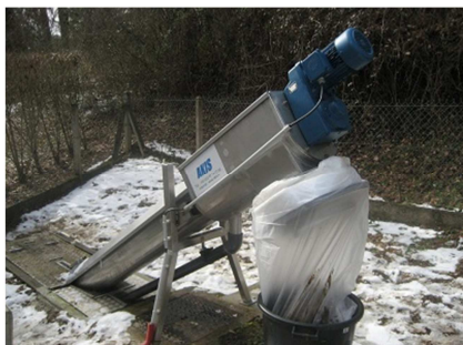
Dégrilleur à vis dans un canal en béton
